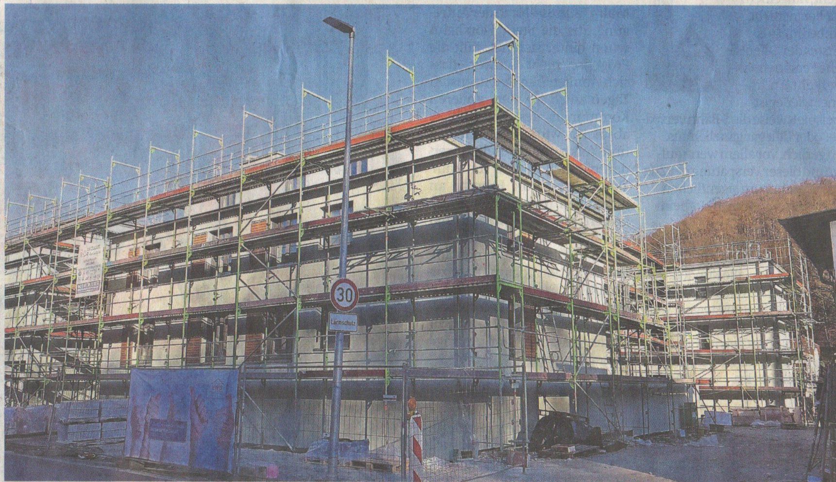
Die Erstellung der Gebäude an der Hofheimer Straße 53–55a liegt im Zeit- und Kostenplan.
