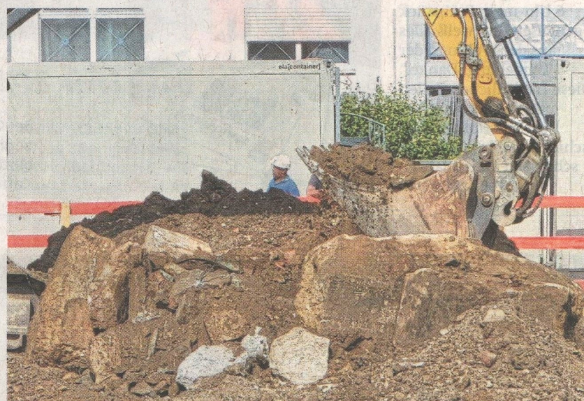
Bei der Bebauung des Nahkauf-Geländes fotografierte der Lorsbacher Thomas Gerner bei der Aushebung der Baugrube Reste alter Fundamente.
